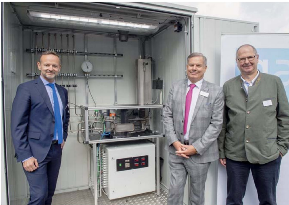
François Fellay (directeur d'Oiken), René Bautz (directeur général Gaznat) et le professeur Andreas Züttel à l'heure de l'inauguration de l'installation Power-to-Gas au poste de détente et de comptage de Sion.
